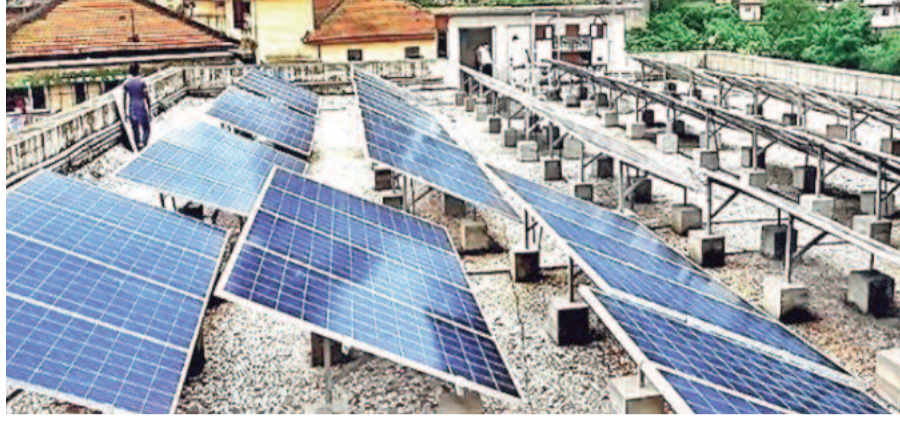
बस व रेलवे स्टेशन भी सौर ऊर्जा से जगमग हुए। मुख्य मार्ग, शौचालय, नगर निगम समेत अन्य जगमग किए। स्मार्ट सिटी परियोजना के तहत नगर निगम, कलक्ट्रेट और
